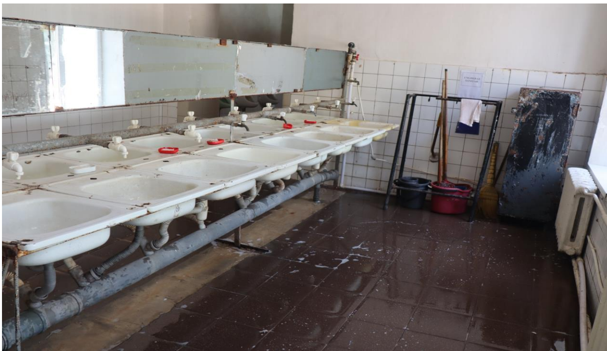
Foto_OAP_bloc sanitar_05.07.2022_compania artilerie
